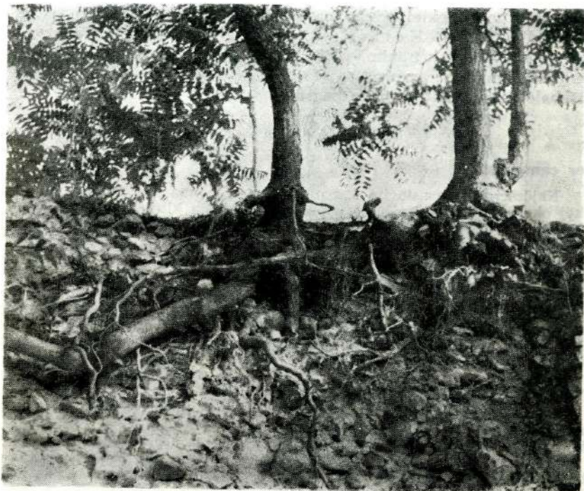
Sl. 15 — Primjer rušilačkog djelovanja korijenja pajasena [ Ailanthus peregrina (Buc.) Backley] na zidinama tvrđave Kaštel
